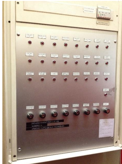
Alarmes locaux techniques
