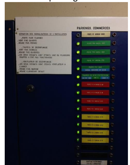
Positions porte coupe-feu et moteur de désenfumage
