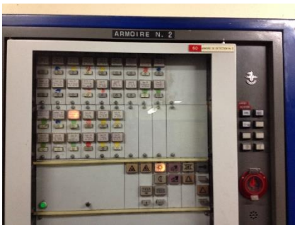
Détection incendie commerce, portes coupe-feu.
