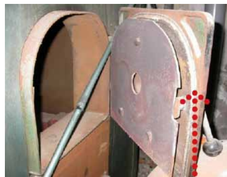
Joints de chaudière
