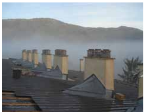
Conduits de cheminées
