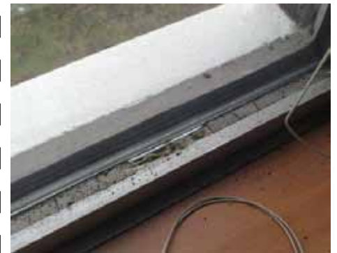
Joints de fenêtres
