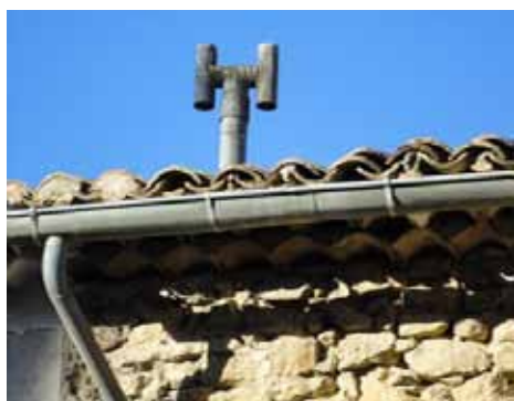
Gaine de ventilation
